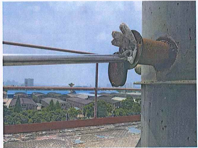
散装水泥卡车装车站收尘机 (DA011) (◎10)
