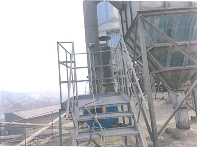
3#水泥原料仓顶排放口（DA033）
