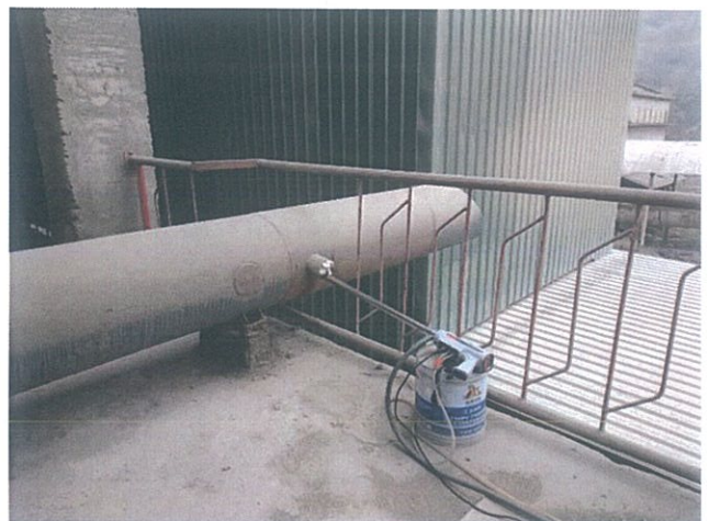
1#包装提升机排放口（DA028）
