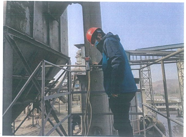
2#水泥原料仓顶排放口（DA032）
