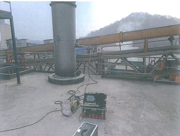
3#磨主收尘机排放口（DA041）
