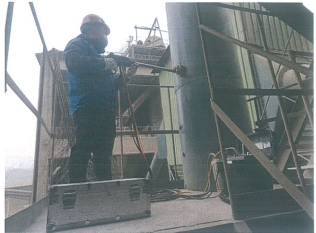
2#水泥磨机头排放口（DA038）
