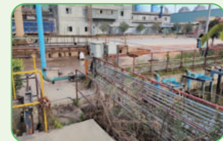
发货侧门卡车洗轮机旁设有污水沉淀池,清洗污水重复使用
